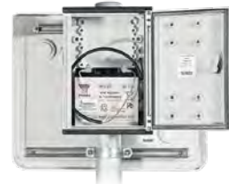
Energieversorgung durch Akku, Netzanschluss oder Nachtauladung (über Straßenlaterne)
